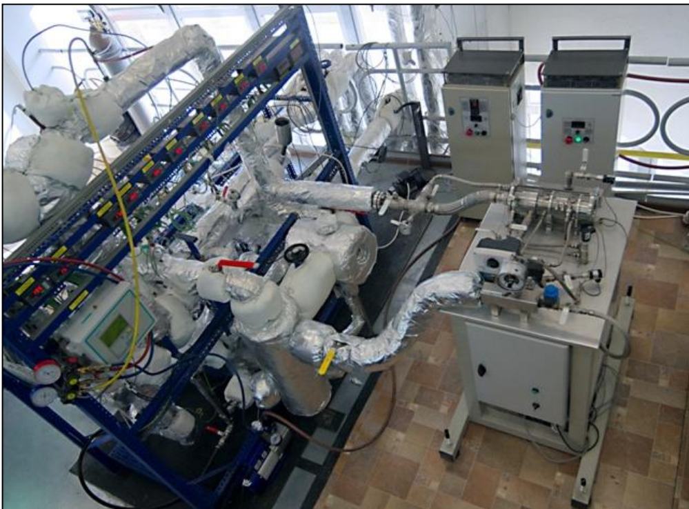
Badania wymienników ciepła i mikroturbiny
